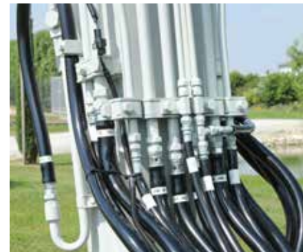
Linee idrauliche in acciaio e morsetti di sostegno in gomma e metallo ben distribuite.
