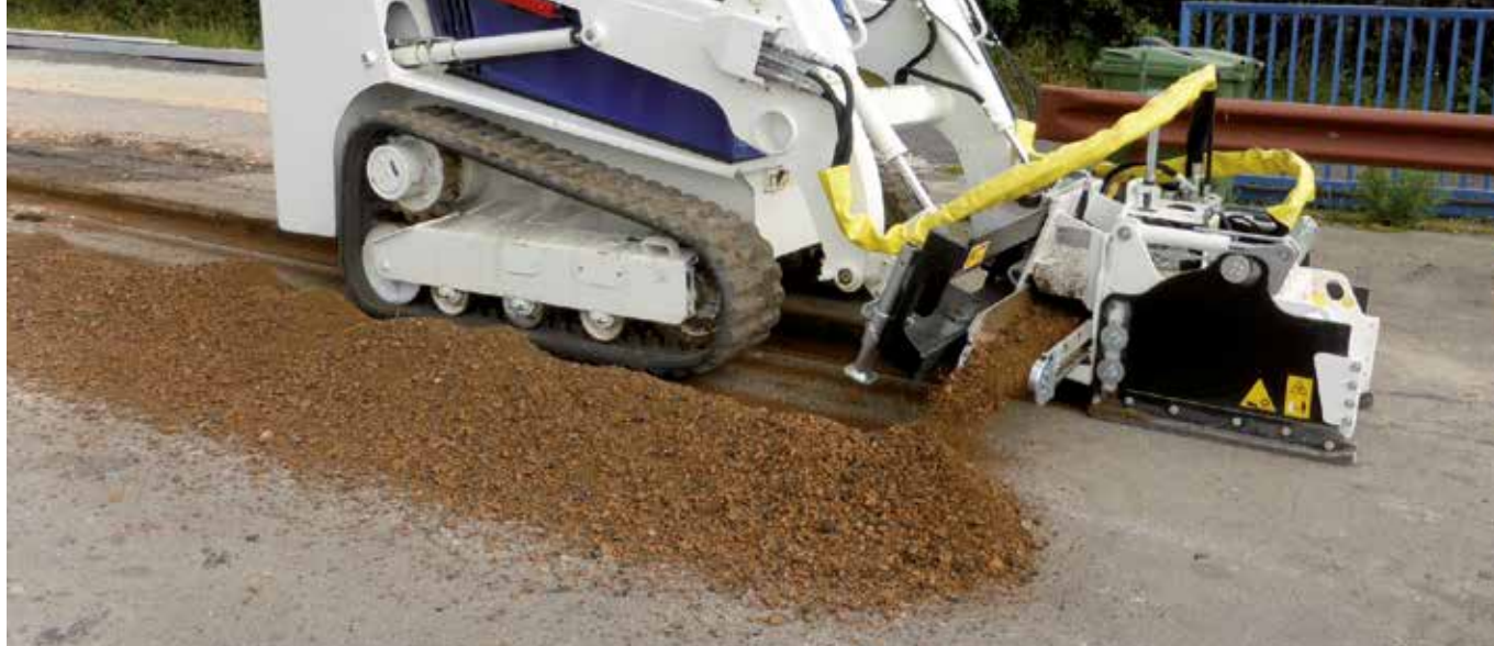
Nastro trasportatore - lo scavo rimane vuoto ed il materiale scaricato a lato
