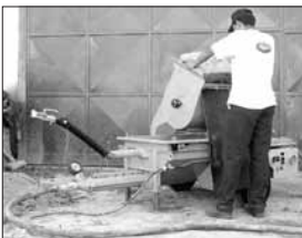
Bassa altezza di carico
